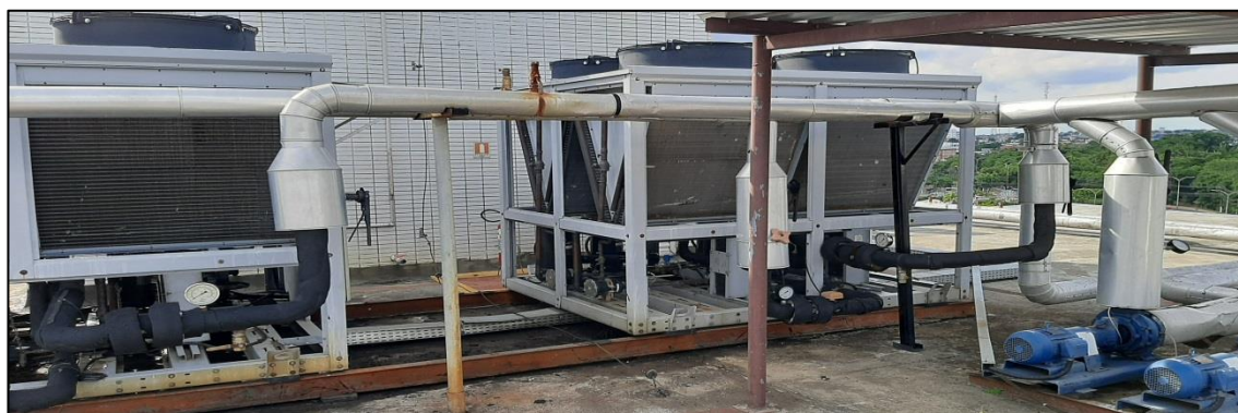
Figura nº09: imagem que ilustra parte do sistema de climatização (chiller)
