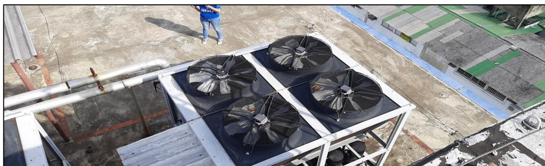
Figura nº 10: imagem que ilustra equipamento de climatização e laje impermeabilizada
