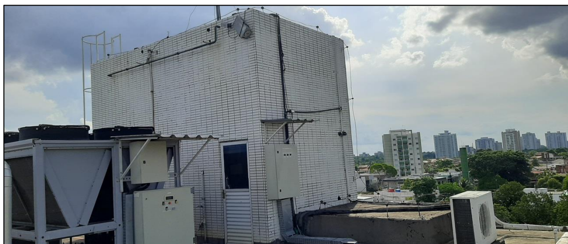
Figura nº 4: imagem que ilustra reservatório superior da edificação e cordoalhas de descida do SPDA
